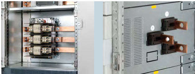
Abb. 4/4: Bestückung in Festeinbautechnik (links) und Anschluss terminals im Kabelanschlussraum (rechts)
