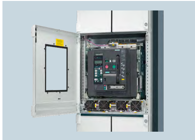
Abb. 3/2: Forcierte Kühlung bei einem Leistungsschalterfeld
