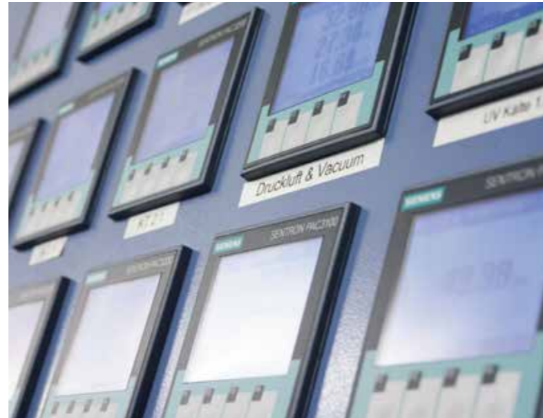
Die kommunikationsfähigen Messgeräte 7KM PAC liefern Daten über den Anlagenzustand
