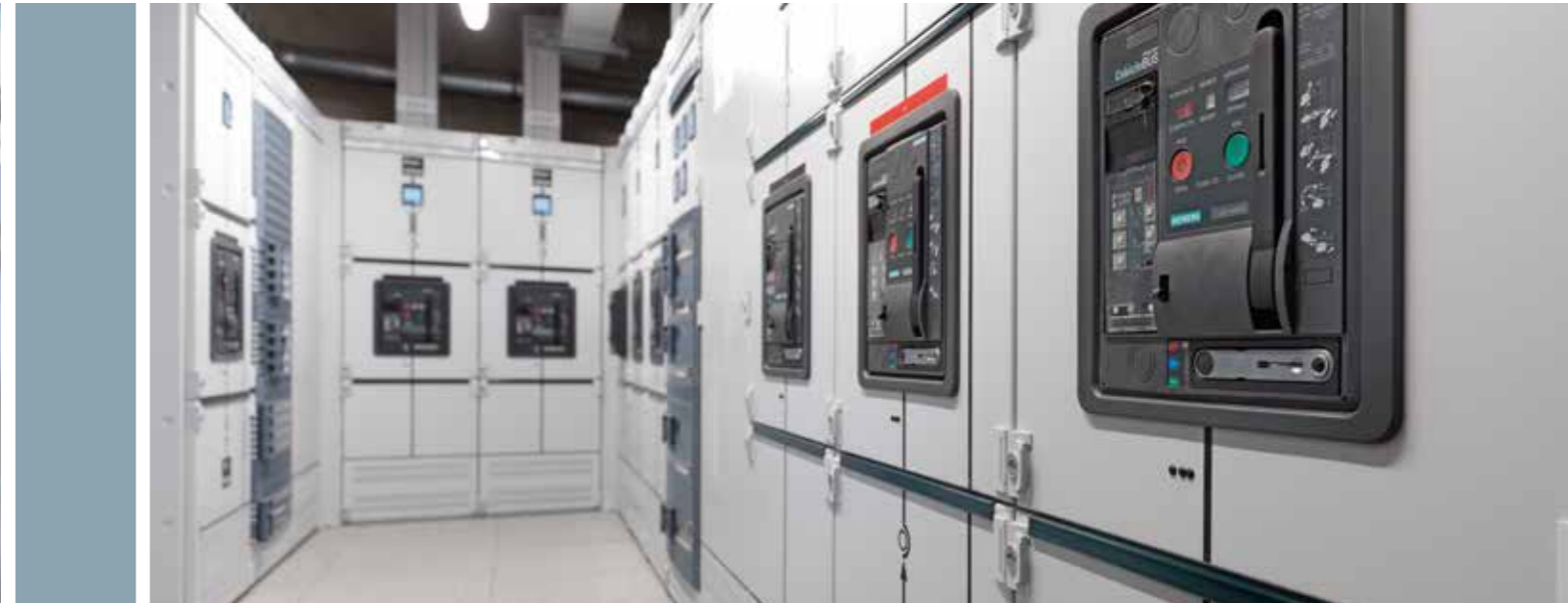
80 Felder der Niederspannungs-Schaltanlage SIVACON S8 sorgen für eine sichere Energieverteilung
